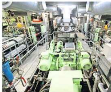
Technik, wohin das Auge schaut: der Maschinenraum der „Bayreuth“.
